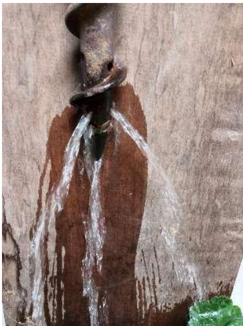
Foto 9. La salida de agua en la parte inferior del taladro.
